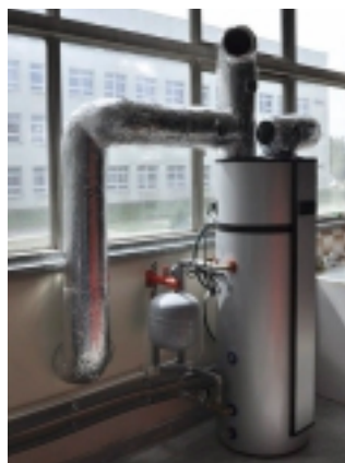
Stanowisko badawcze do badań efektywności pompy ciepła do podgrzewania wody użytkowej w Laboratorium Inżynierii OZE na WIM UTP w Bydgoszczy
